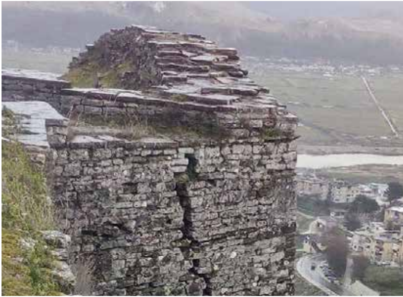
Ein beträchtlicher Riss geht durch die Burgmauern. Foto: Kreshnik Merxhani
